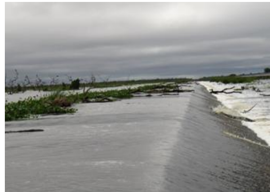
Zona de vertedero -Ruta 28
